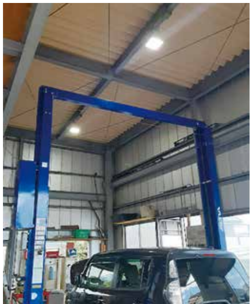
更新した照明 (LED)
